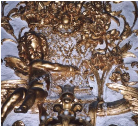
Schlafzimmer Taupunktschäden an der Nordwand
