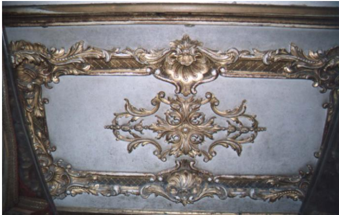
Starke Abnutzung der gefassten Holzvertäfelungen und des Mobiliars, teilweise bis aufs Holz in allen Schauräumen
